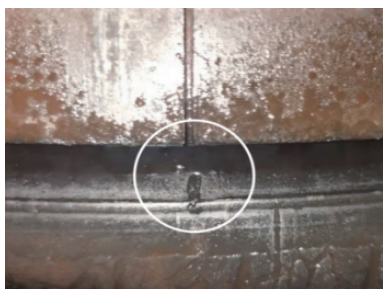
图9 夹环排气线位置损伤
